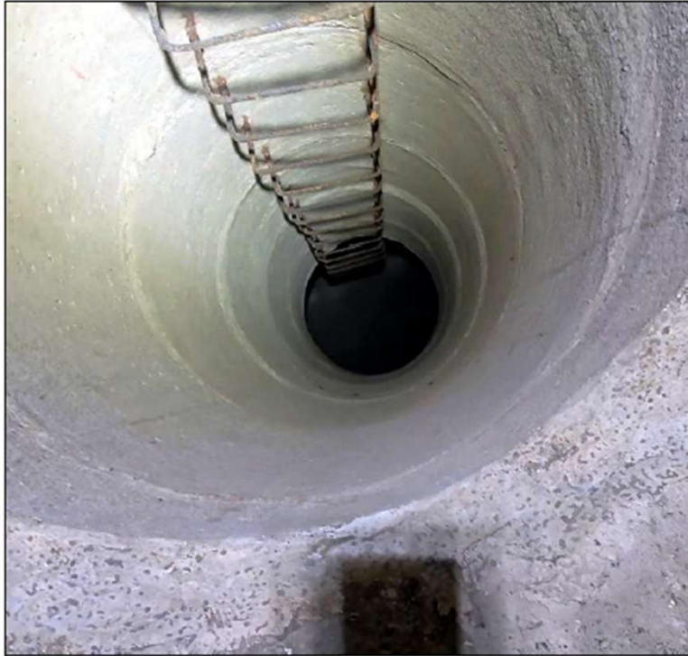
Foto n° 8: Pozzo visto dal basso che parte in un locale presente nella Galleria Laziale.
